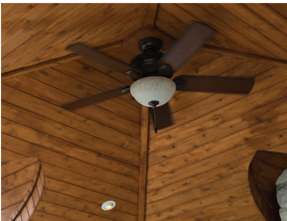
CEILING FAN & LIGHTS
